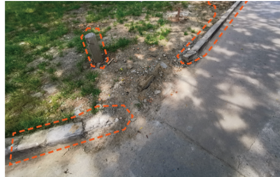
d. A broken curb
