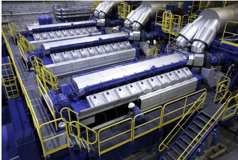
Fig. 1-1. Wärtsilä Goodman Energy Center in Kansas.
