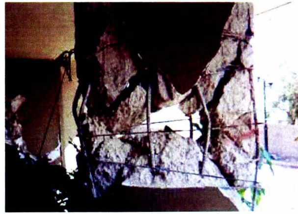
(d) Shear failure in column and local buckling
