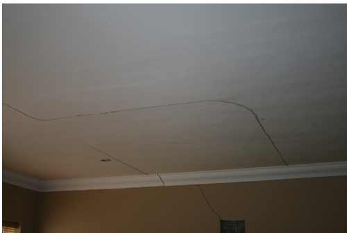
(d) Cracking to kitchen wall and ceiling, maximum crack width 8 mm
